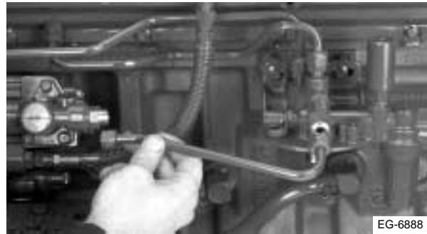
Figura 13.14 Instalación de la tubería que va desde el cabezal del filtro a la bomba
